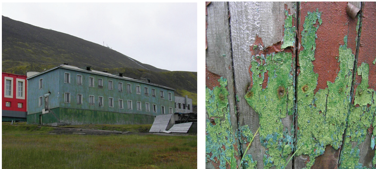
Рис. 4.21. Жилое здание и фрагмент состояния отбираемого красочного покрытия наружной стены
