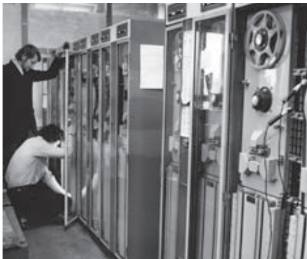
БЭСМ-4. Зал с накопителями на магнитных лентах
